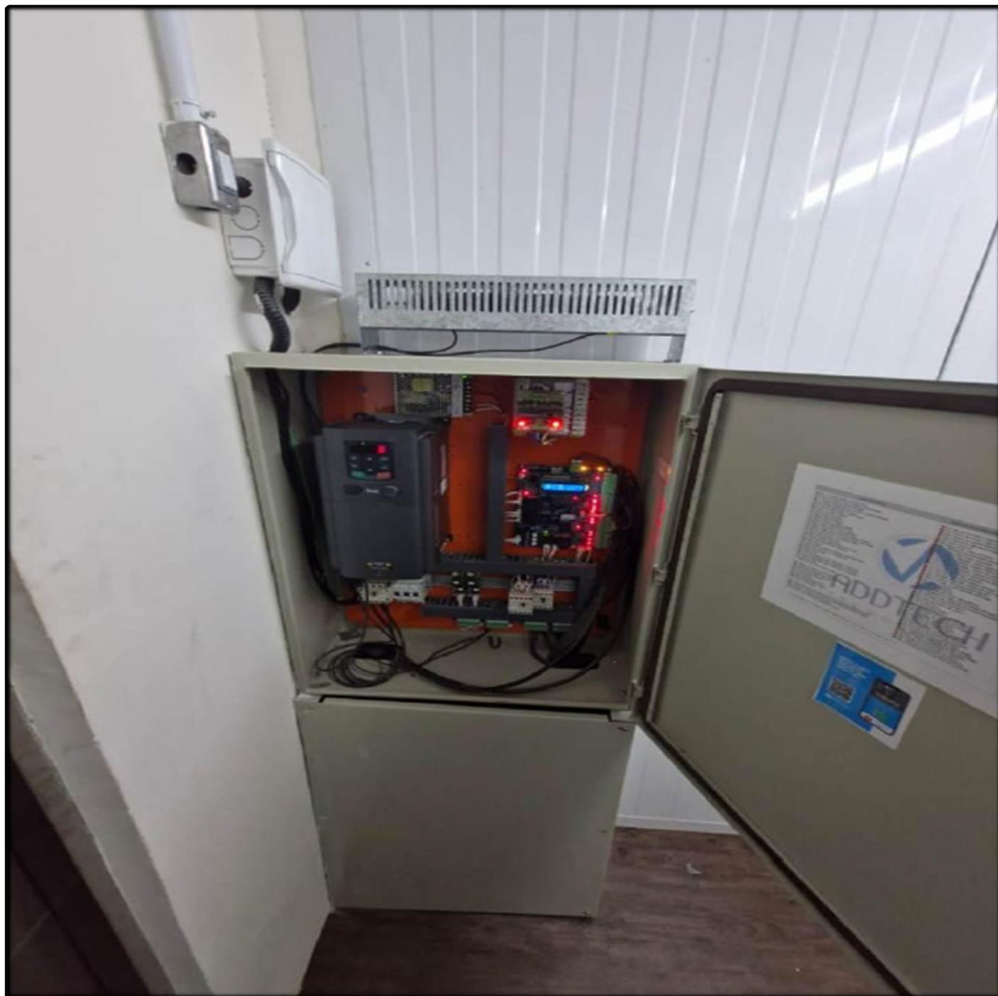
Figura 28 – Quadro elétrico e de comando.
