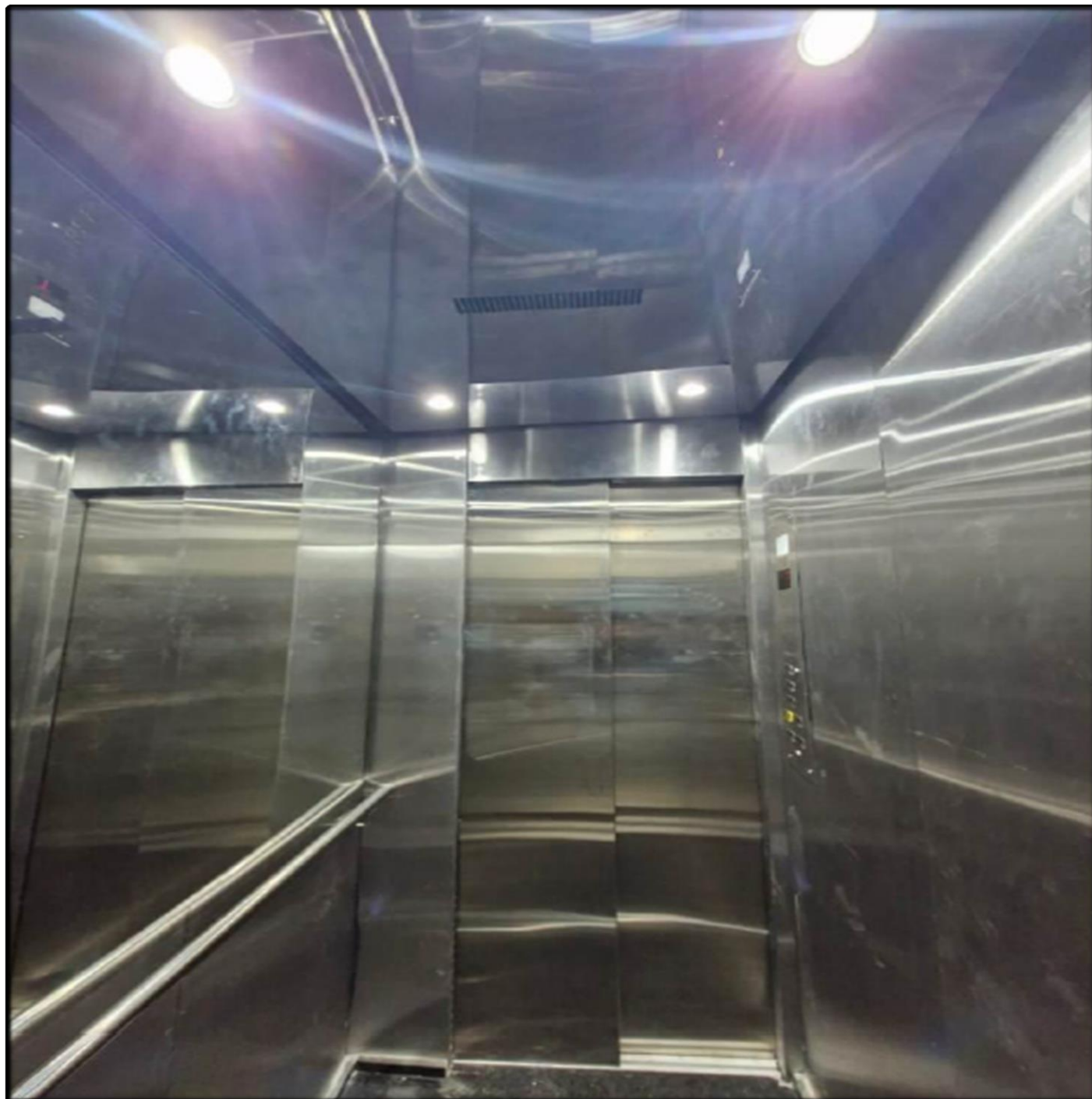
Figura 05 – Elevador área estacionamento, acabamentos internos.
