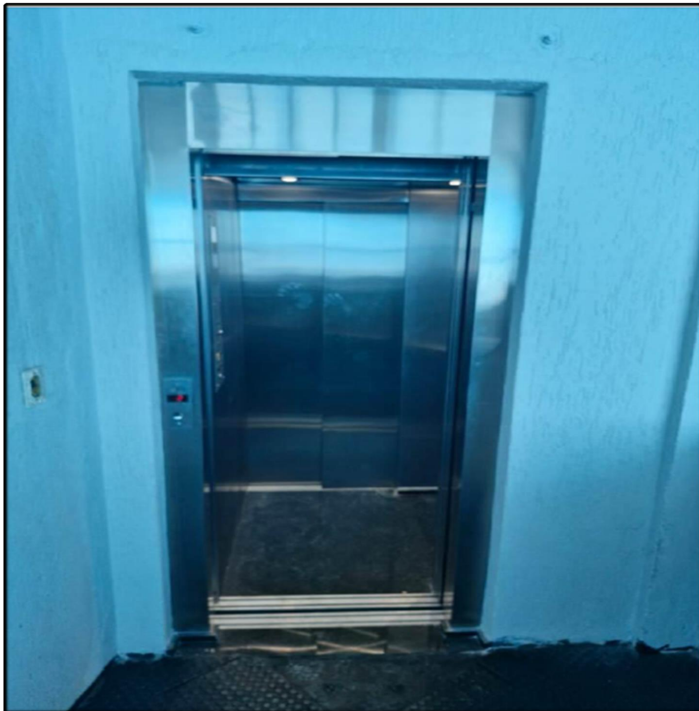
Figura 25 – Elevador área recepção, acabamentos internos.
