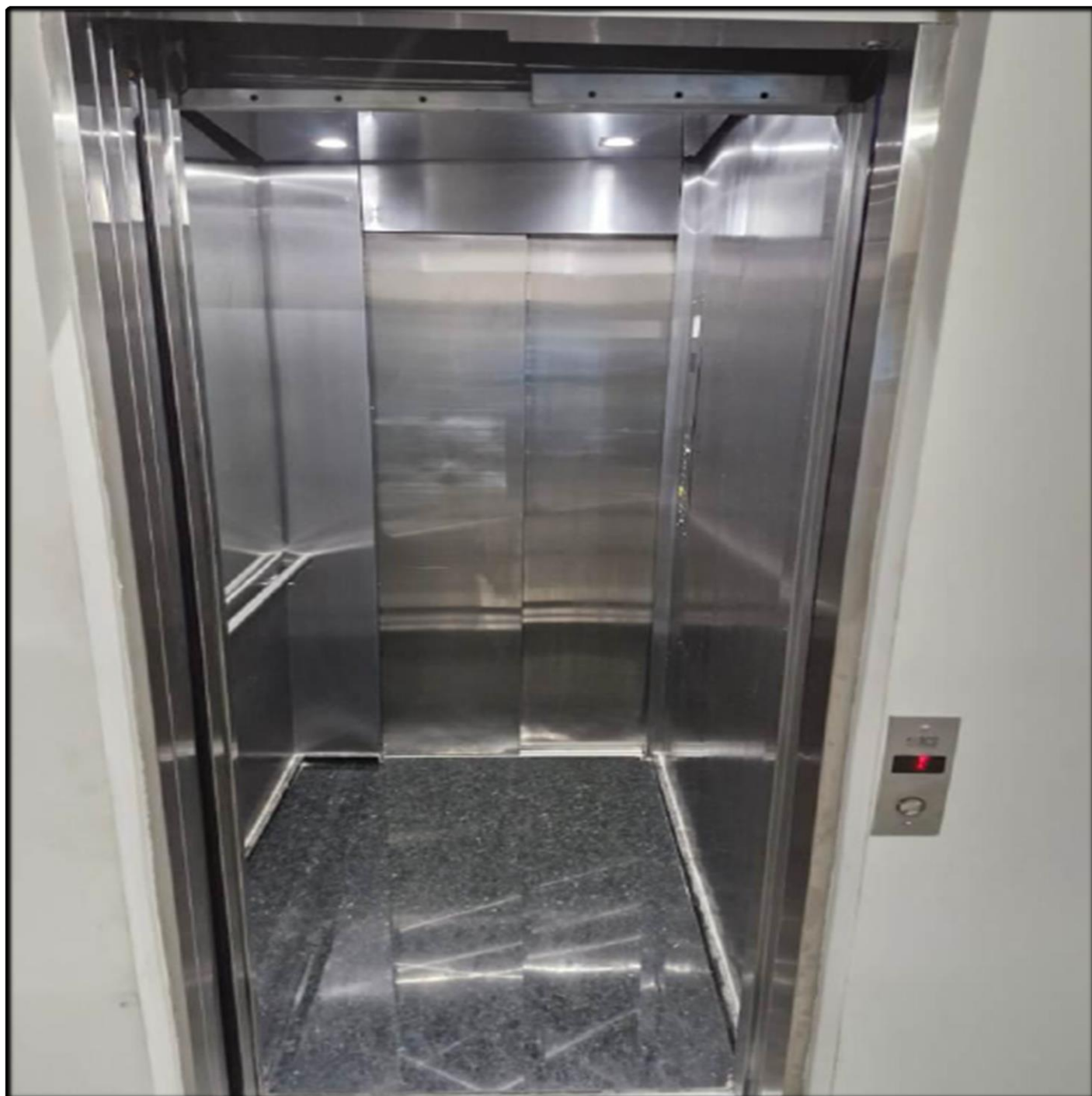
Figura 13 – Elevador área estacionamento, acabamentos internos.
