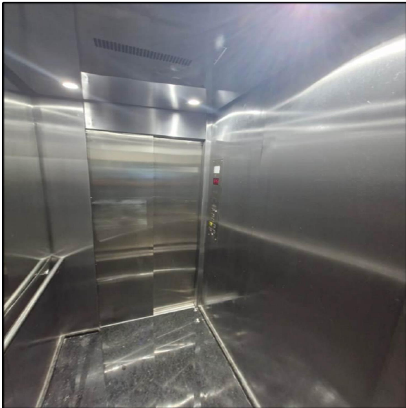
Figura 10 – Elevador área estacionamento, acabamentos internos.
