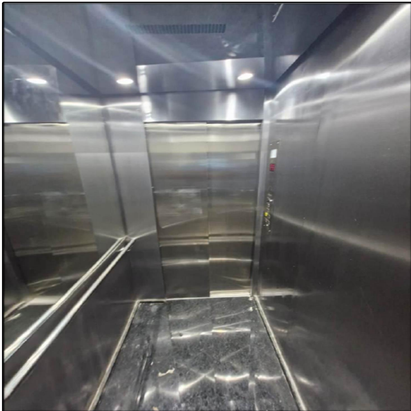
Figura 08 – Elevador área estacionamento, acabamentos internos.
