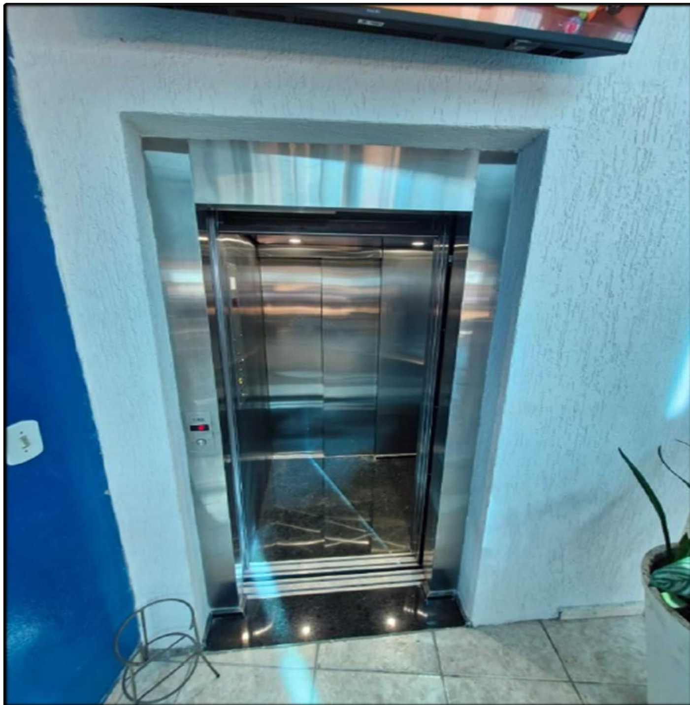
Figura 26 – Elevador área recepção, acabamentos internos.
