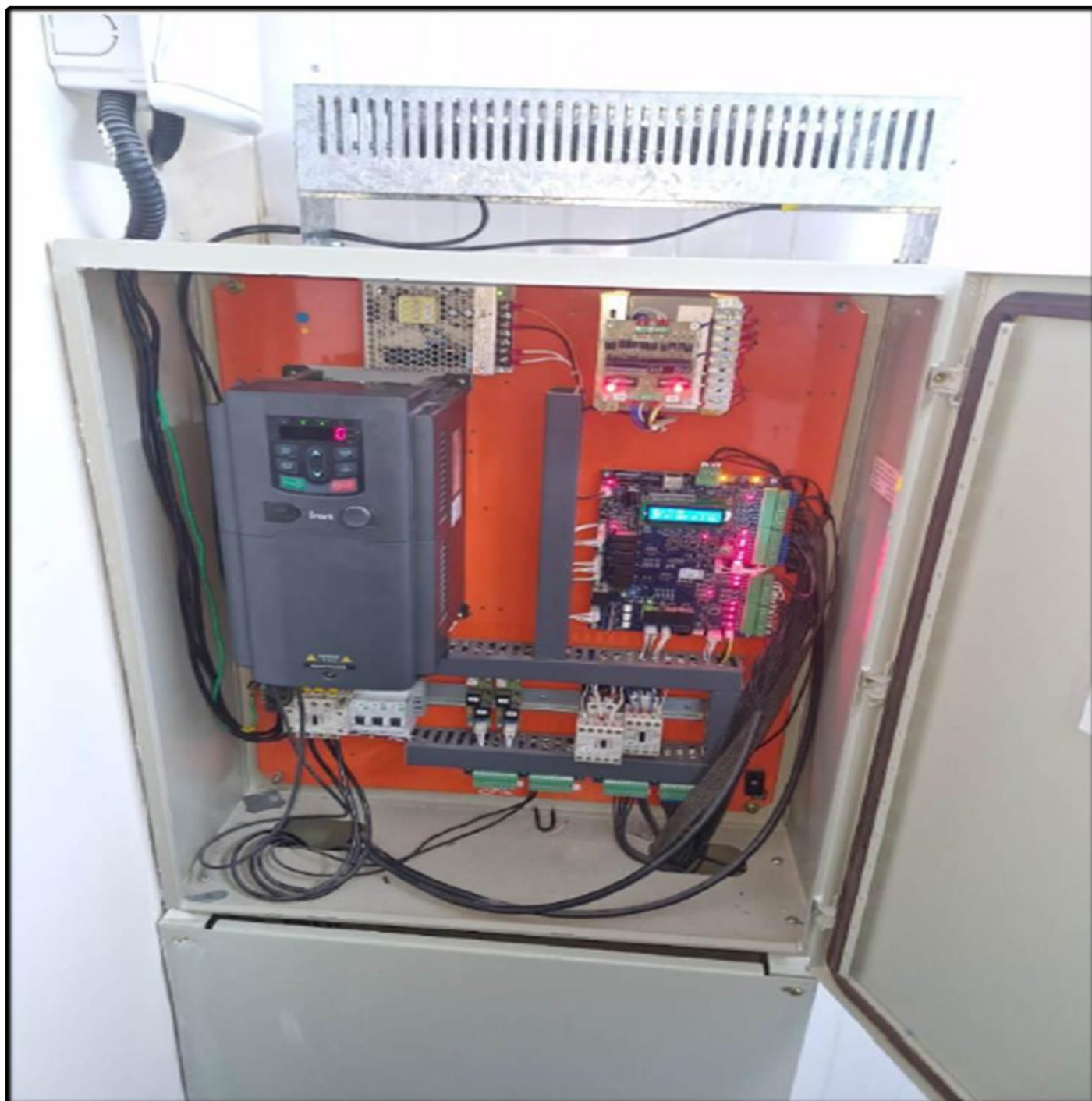
Figura 27 – Quadro elétrico e de comando.
