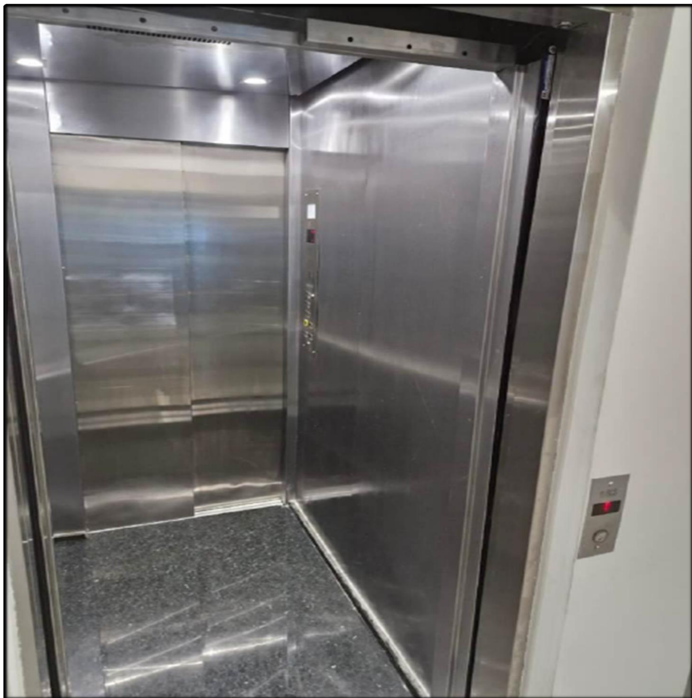
Figura 12 – Elevador área estacionamento, acabamentos internos.
