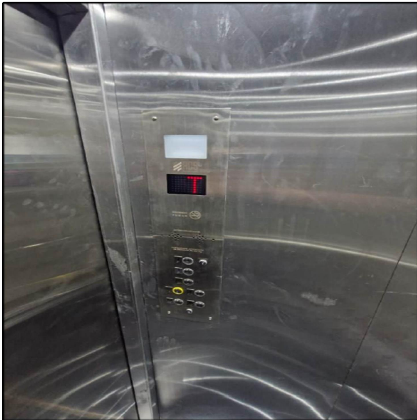
Figura 06 – Elevador área estacionamento, acabamentos internos.
