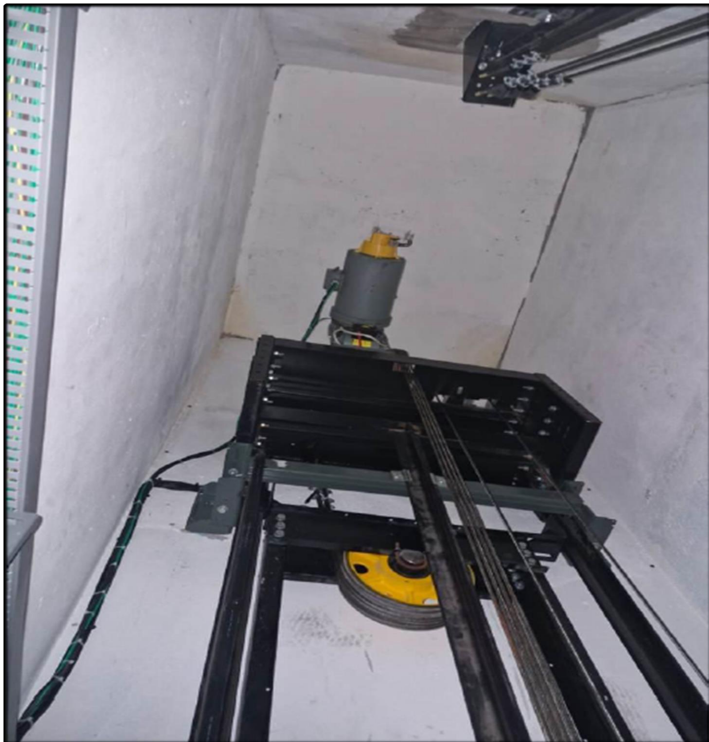
Figura 16 – Instalações mecânicas dos elevadores.
